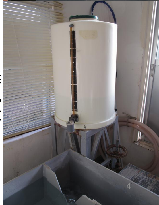
塩素 注入 装置
