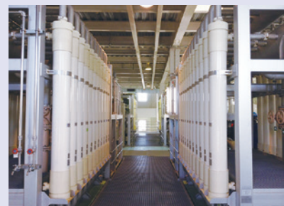
浄水施設の膜モジュール
