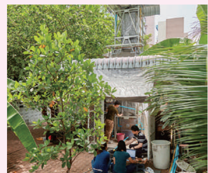
タイ、バンコクの集合住宅に設置した排水処理実証試験装置 Wastewater treatment pilot scale plant placed in the apartment in Bangkok, Thailand
