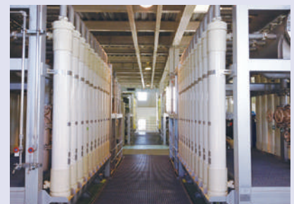
浄水施設の膜モジュール Membrane modules at a water purification plant
